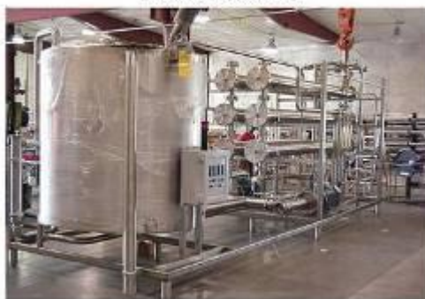
Рисунок 15 – Промышленные мощности для производственной ультрафильтрации
